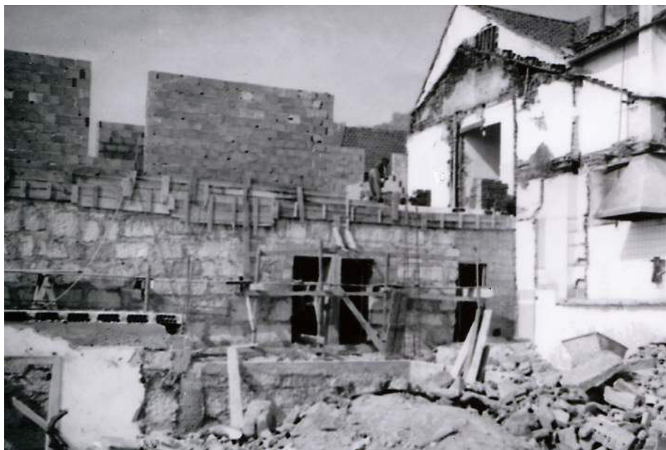
O mau estado em que se encontrava o edifício do Patronato antes das obras de reconstrução.
